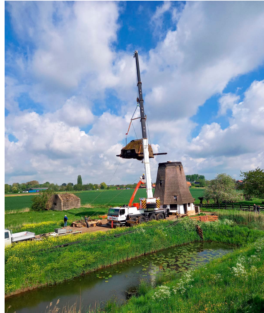
Kap van molen de Vervoorne Polder (Werkendam) wordt gelicht ten behoeve van het herstel van de scheefstand in 2021 (foto: molenstichting Land van Heusden en Altena).
